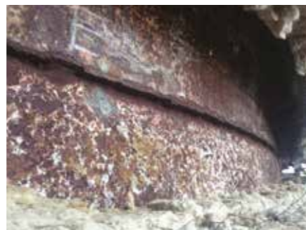
Umlaufende Risse an der Standzarge
