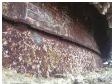
Grieta circunferencial en faldón
