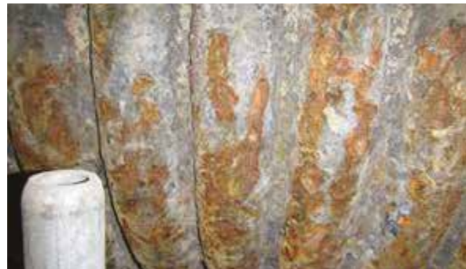
Corrosão do lado da chama em uma caldeira a carvão
