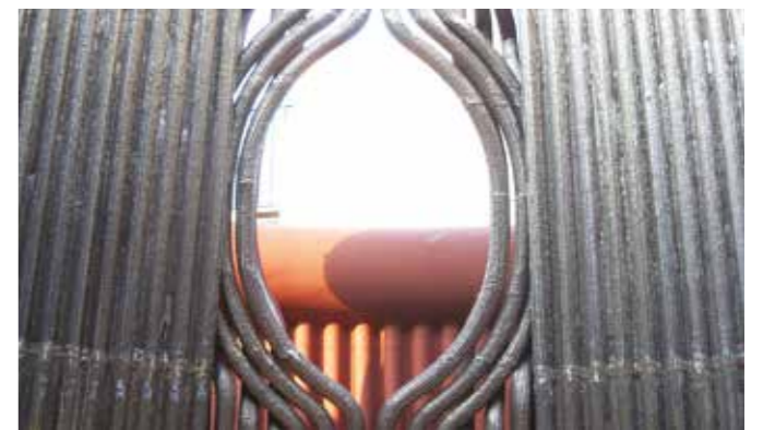
360° geschweißte Rohre mit Ausbiegungen
