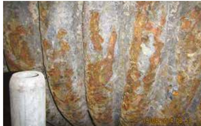
Rauchgasseitige Korrosion in einem kohlebefeuernden Kessel
