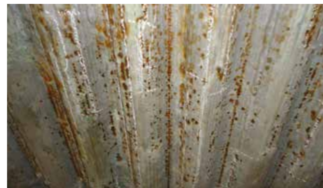
Parete membranata dopo il test del solfato di rame
