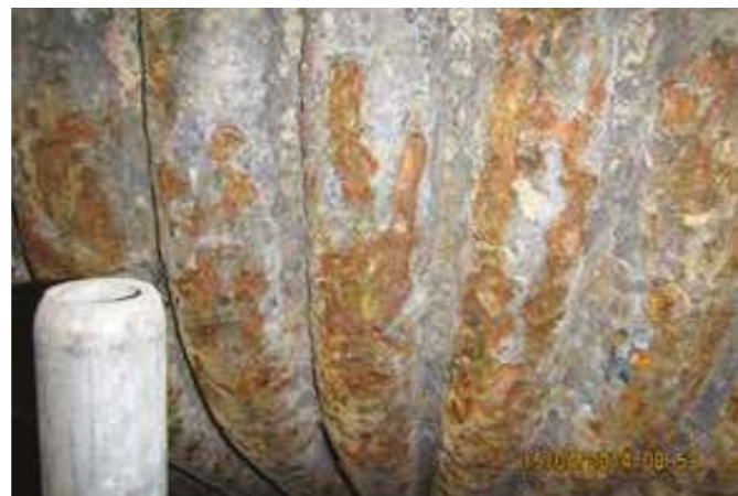
Corrosione lato fiamma in una caldaia a carbone
