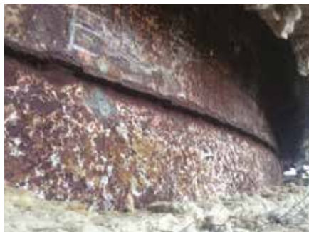
Grieta circunferencial en faldón
