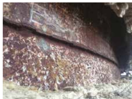
Grieta circunferencial en faldón
