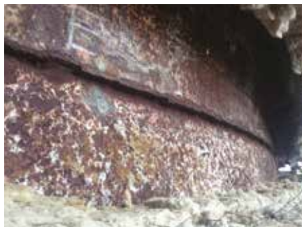
Fissures sur tout le pourtour de la jupe
