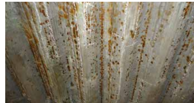
Paroi d'eau après un test au sulfate de cuivre
