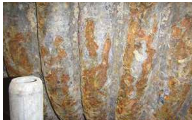
Corrosion côté chaudière dans les chaudières à charbon
