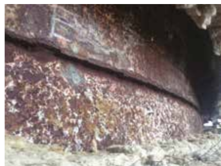
Grieta circunferencial en faldón
