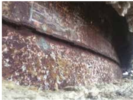
Fratura em toda a circunferência da camisa
